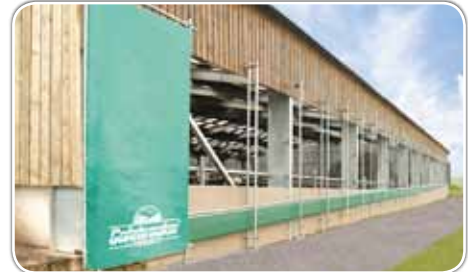
Variable Seitenlüftung - ganz offen für hohe Luftraten im Sommer
